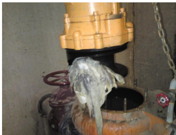
Textilien im Pumpenlaufrad
